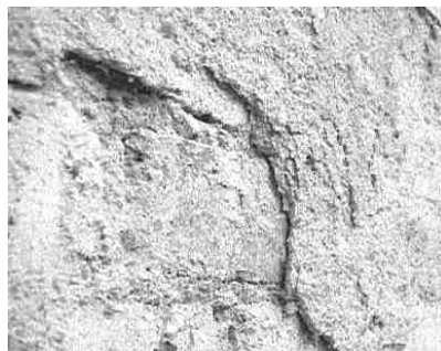
Fig.5 Aspecto del revoco. Edificio de Lisboa
