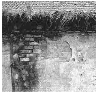
Fig.2 Aspecto del revestimiento del edificio de Lisboa
